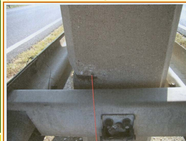
Slika 80. Otpadanje zaštitnog sloja i korozija armature
