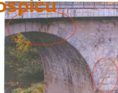
Slika 100. Vidljivo curenje vode po dijelovima mosta s korodirane cijevi ispod vijenca
