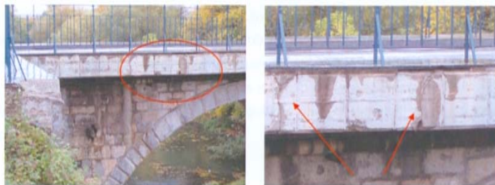
Slika 99. Uočena oštećenja na vijencu zaokružena (lijevo) i uvećan detalj (desno)
