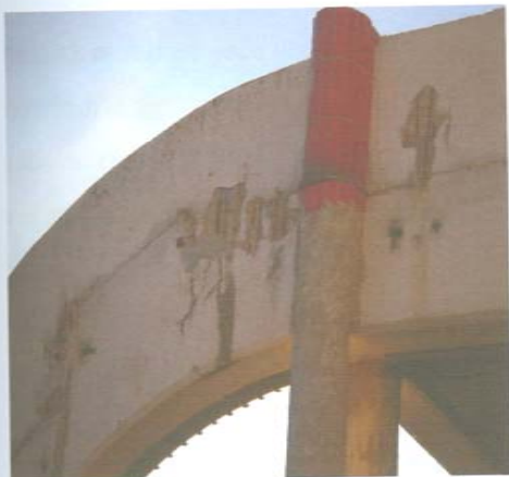
Sl.1.1. – Korozija armature
