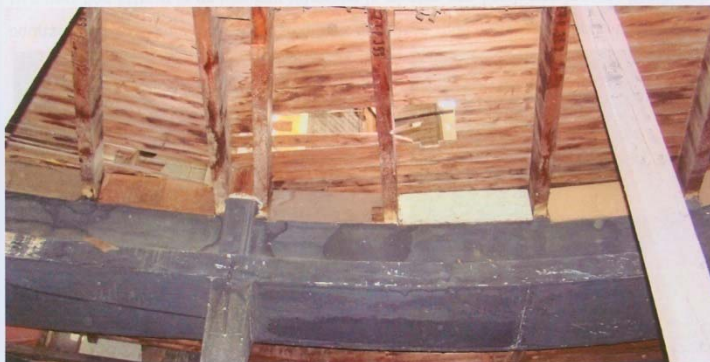
Slika 46. Stupovi i grede obloženi čeličnim limom
