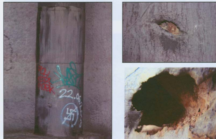
Slike 56. Oštećenja stupova
