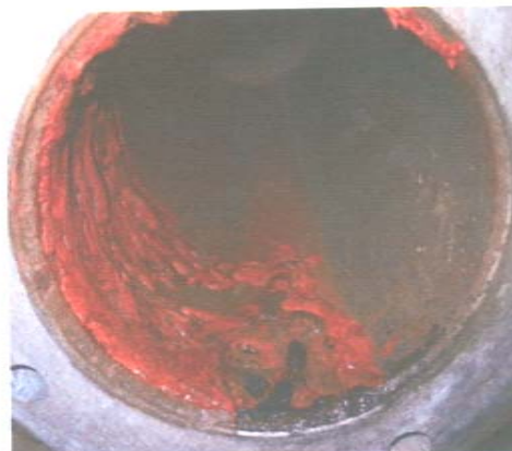
Sl.1.4. – Korozija metalne konstrukcije
