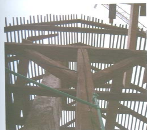
Sl.1.3. – Raspucavanje drvene građe
