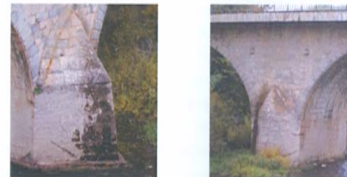
Slika 101. Prisutnost gljivica na zadebljanjima stupova na uzvodnoj (desno) i nizvodnoj strani (lijevo)
