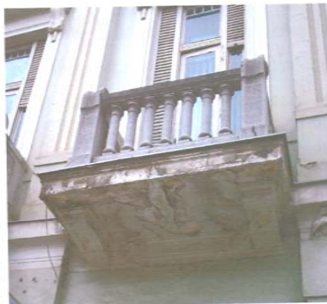
Sl.1.2. – Otpadanje zaštitnog sloja betona
