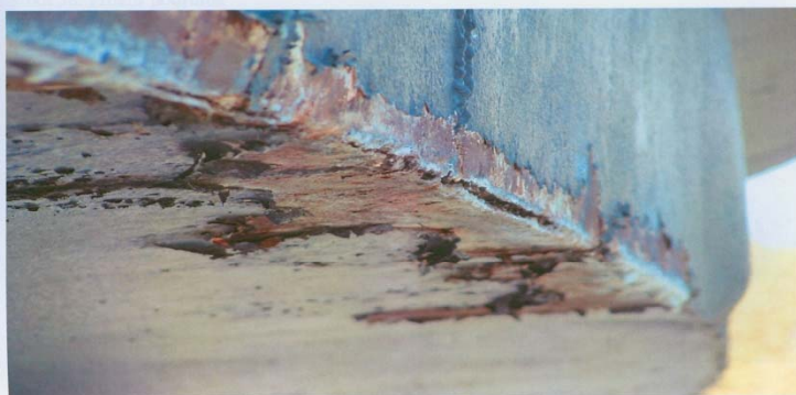
Slike 57. Oštećenje tlačnog prstena
