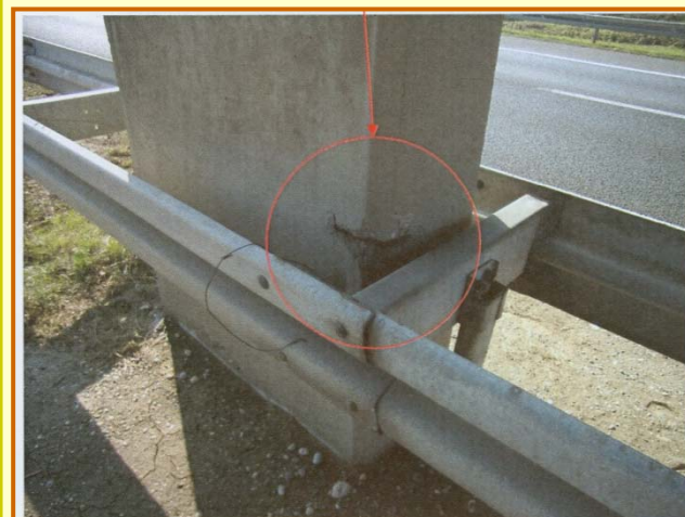
Slika 81. Otpadanje zaštitnog sloja i korozija armature
