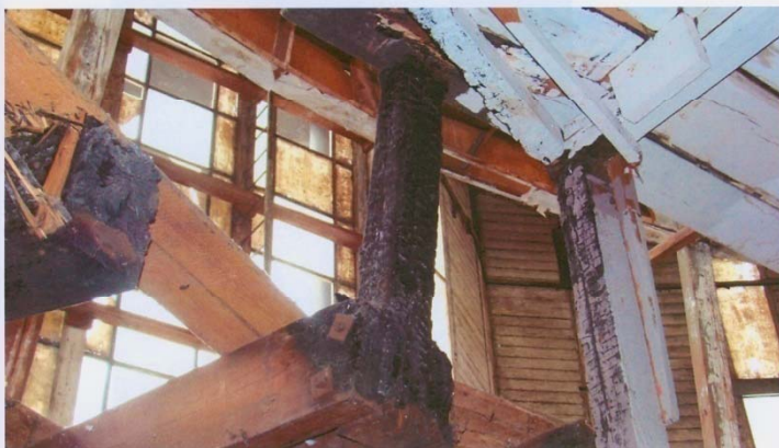
Slika 45. Detalj konstrukcije prve etaže zahvaćen požarom
