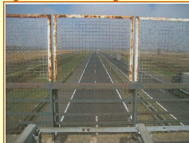
Slika 50. Korozija ograde i zaštitne ograde
